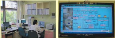
■ 文書處理器可監控全庫的中央監控系統與庫內人員進出狀況
